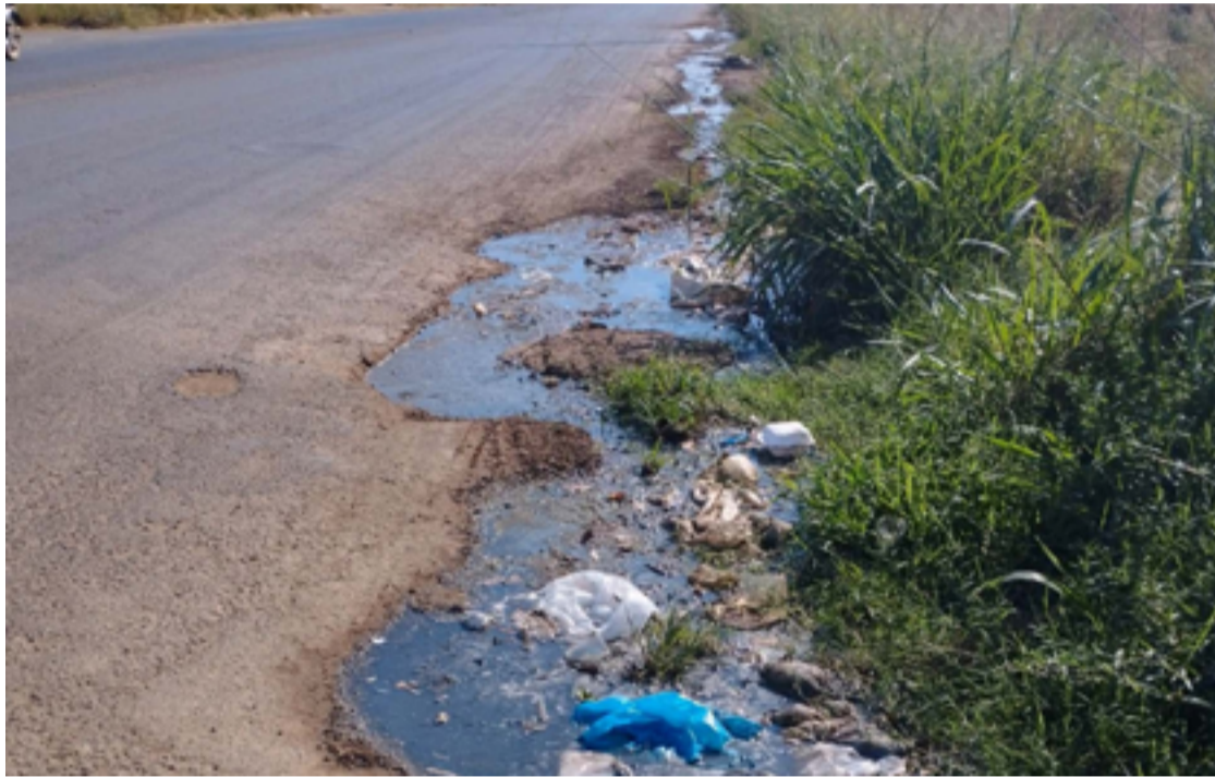
Com o vazamento, estaria escorrendo esgoto na via pública até o Córrego Portal, causando contaminação e poluição ao meio ambiente.
